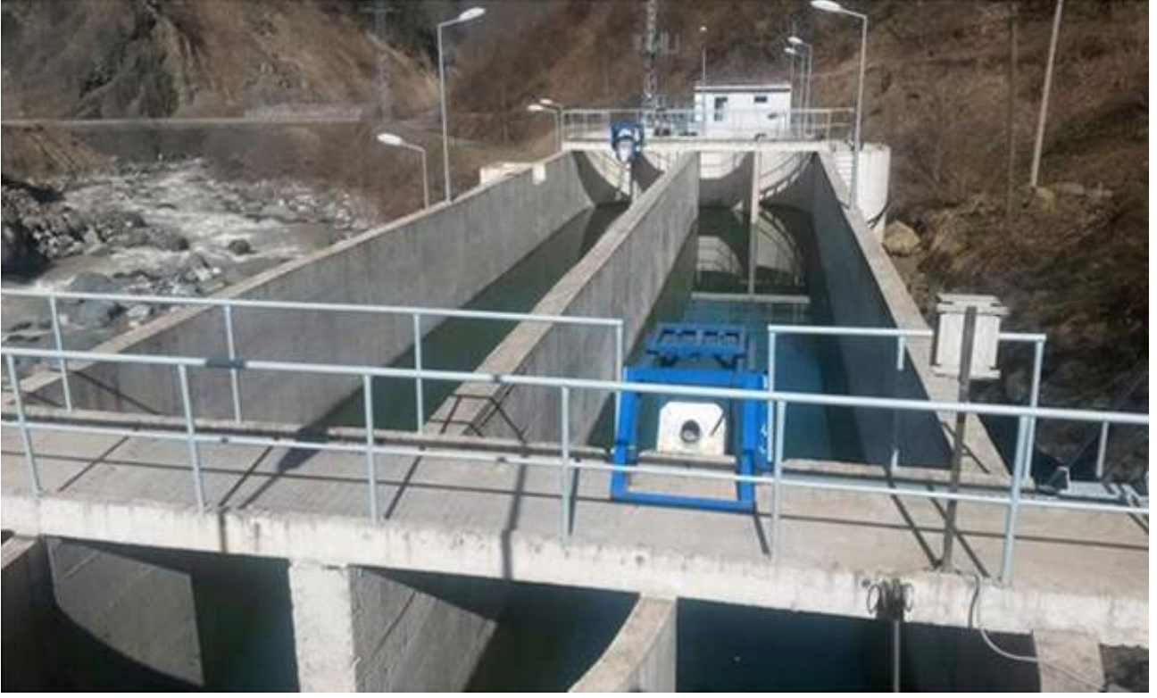
Tonya Biyolojik Atıksu Arıtma Tesisi
