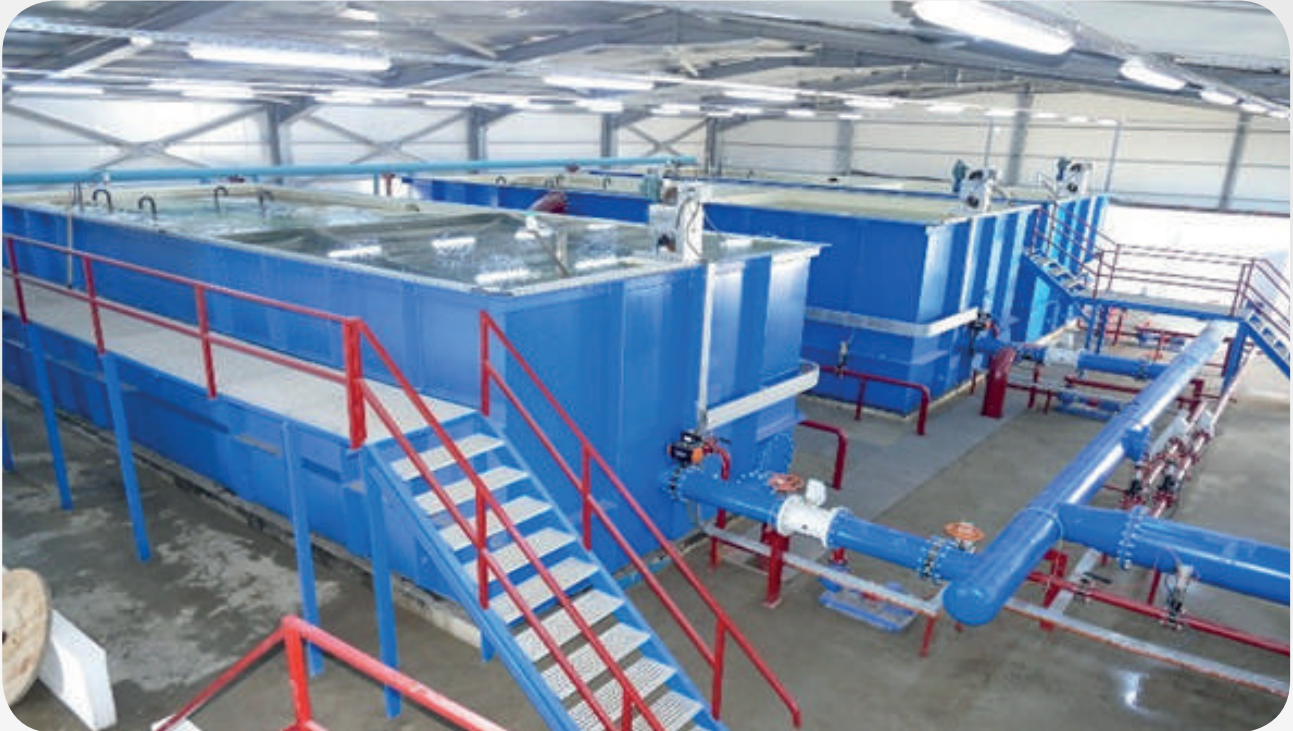
Karakaya Grup İçme Suyu Arıtma Tesisi
