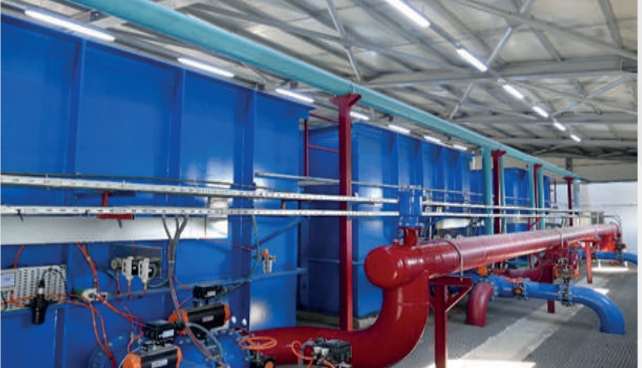
Karakaya Grup İçme Suyu Paket Arıtma Tesisi
