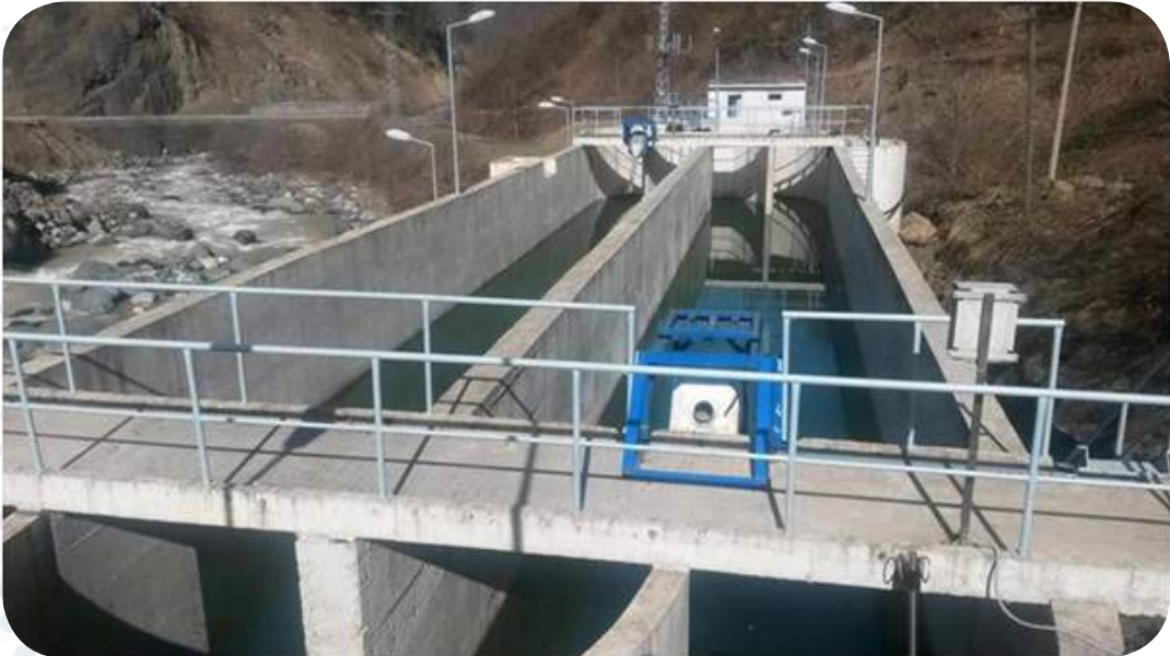
Fotoğraf- 108 Tonya Biyolojik Atık Su Arıtma Tesisi
